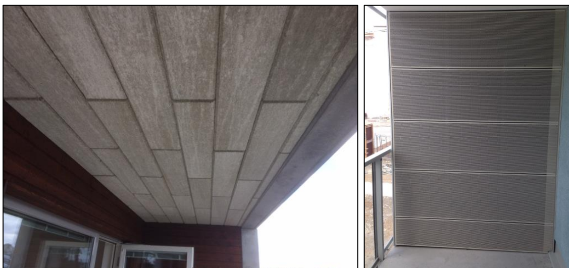
Figur 7. Exempel på absorbent på balkong. T.v. 50mm Paroc cgl 20cy, Kv. Ombudsmannen, Linköping. T.h. Akustikskiva 50mm bakom perforerad plåt.
