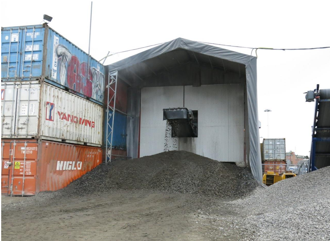
Figur 1 Exempel på en inklädd krossanläggning.
