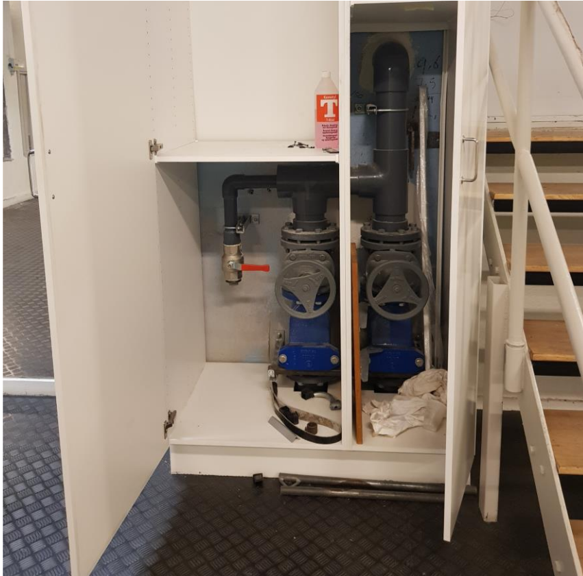
Figur 4: Ledning och reglage av pumpen
